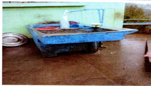
Foto 2: La pila se ha deteriorado en los lavaderos tambien donde se acumula el agua por la anitguedad que tiene y esta será sustituida
