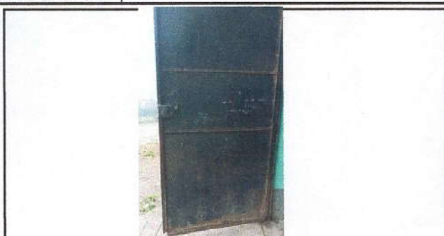
FOTO. 1 PUERTAS DE METAL
