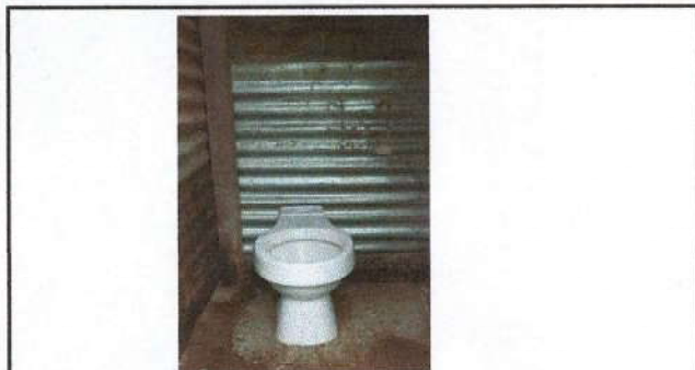
FOTO. 3 SERVICIOS SANITARIOS Y ACCESORIOS
