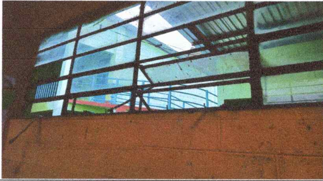
Antes: Renglon de ventanas, se sustituirán los vidrios ya que se encuentran en mal estado
