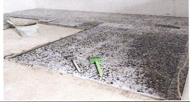
FOTO 8: Sustrucción de piso de granito
