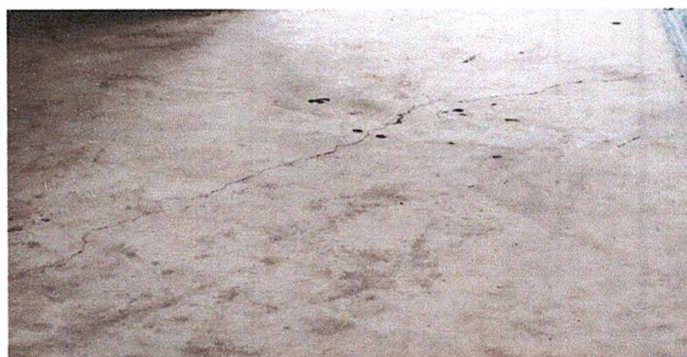
FOTO 4: Sustrucción de piso de granito
