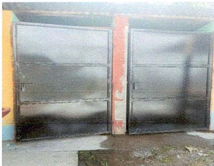
Foto 7: Sustrucción de puerta 2 metros de alto por 1.01 metro de ancho
