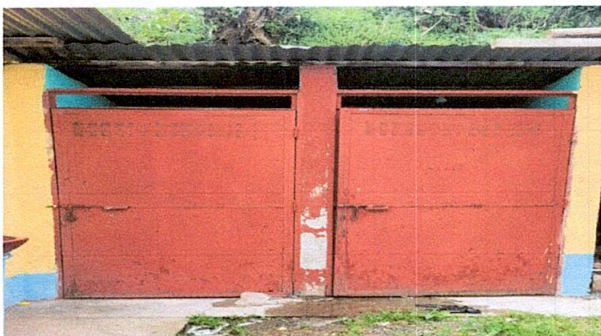
Foto 7: Sustrucción de puerta 2 metros de alto por 1.01 metro de ancho
