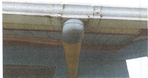
Foto 4: CANALES Y BAJADA DE AGUA PLUVIAL
