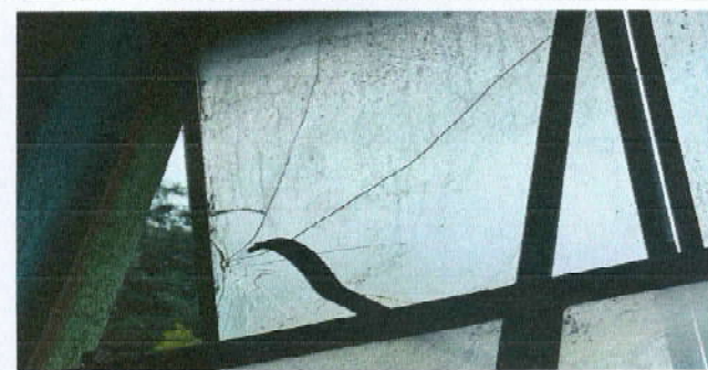
Foto 12: Sustrucción de vidrios ventanas
