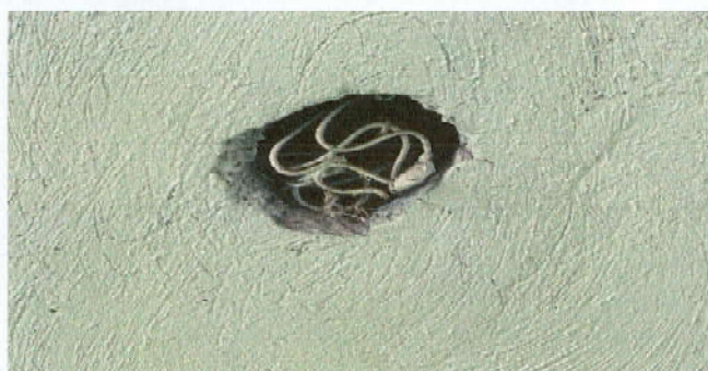
Foto 25: Sustrucción de plafoneras
