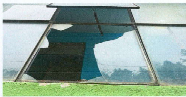
Foto 8: Sustrucción de vidrios ventanas
