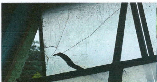
Foto 10: Sustrucción de vidrios ventanas
