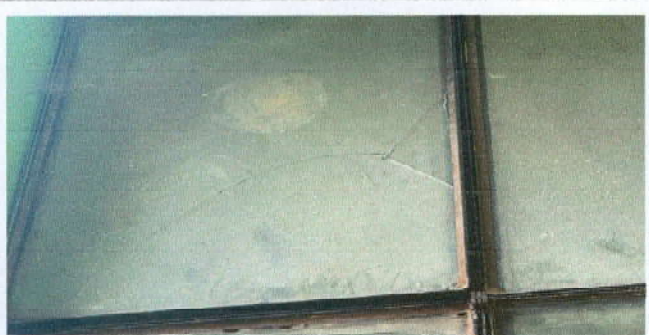
Foto 11: Sustrucción de vidrios ventanas
