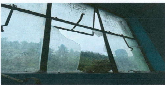
Foto 9: Sustrucción de vidrios ventanas
