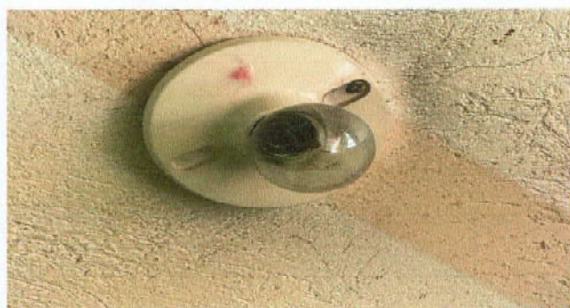
Foto 28: Sustrucción de plafoneras
