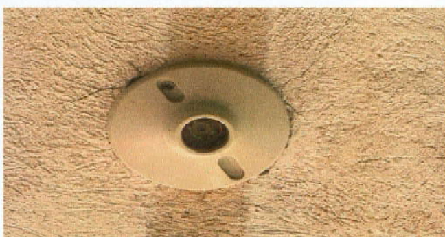
Foto 27: Sustrucción de plafoneras
