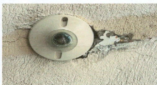
Foto 26: Sustrucción de plafoneras
