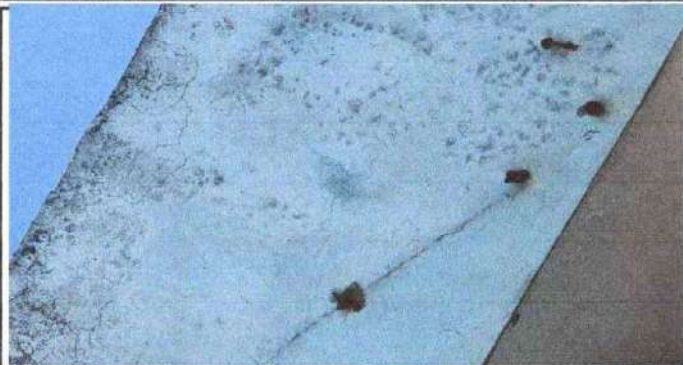
Foto 1: Cubierta de lámina: Sustrucción de elementos de fijación (tornillos).
