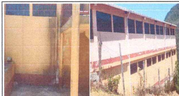
Foto 5: Aplicación de pintura en el exterior de edificio
