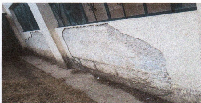
Foto 11: Repello en muro de la escuela
