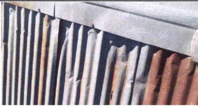
Foto1: Sustitución de lámina por mal estado.
