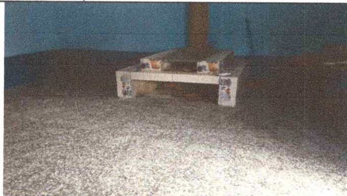
Foto 8: Sustrucción de piso de granito
