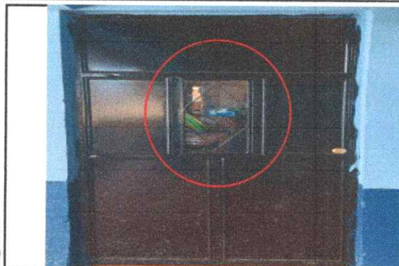
Foto 7 :Sustrucción de vidrios
