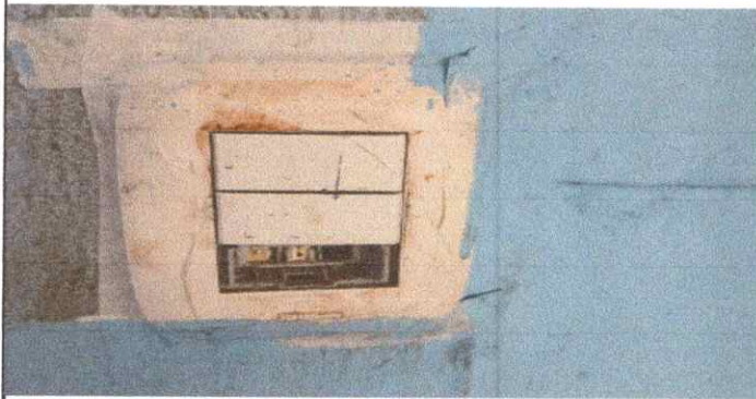
Foto 13: Sustrucción interruptores dobles
