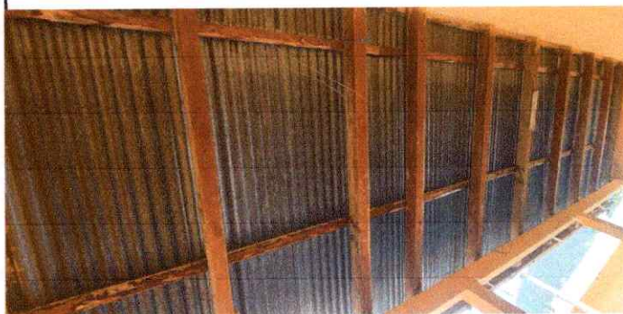
Foto 8: Sustrucción de estructura de soporte de madera, por metal, de 222 ML se encuentra malas condiciones
