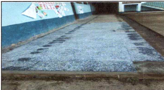
Foto 8: Sustrucción de piso de granito
