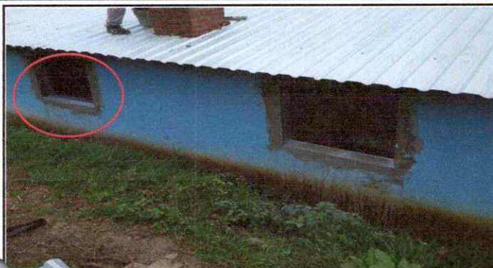
Foto 7: Sustrucción de estructura de metal de ventana
