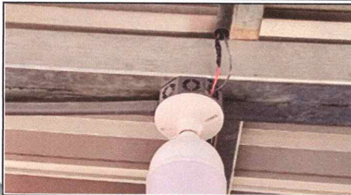
Foto 13: Sustrucción de plafoneras
