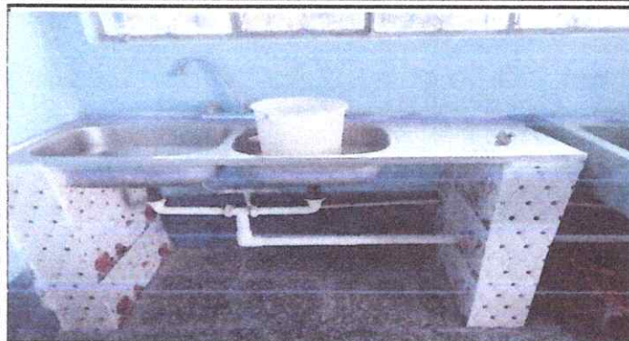
Foto 19 .Sustrucción de azulejo en Lavatrastos en la cocina
