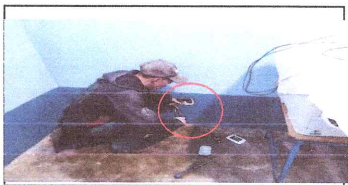
Foto 12: Renglón 17. Sustitución de tomacorrientes dobles.
