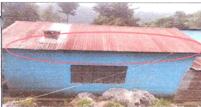
Foto 23: Sustrucción de soporte o pescante de metal para canal.
