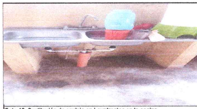
Foto 18 .Sustrucción de azulejo en Lavatrastos en la cocina
