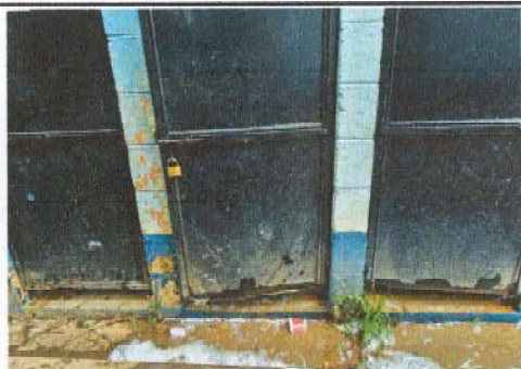
Foto 3: Sustrucción de puerta de baños en mal estado
