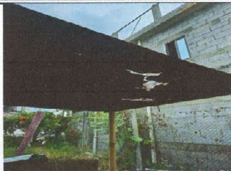
Foto 1: Sustrucción de estructura de lámina en área de preparación de alimentos en malas condiciones
