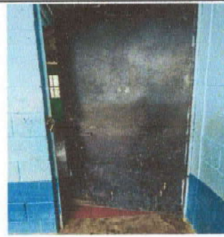
Foto 4: Sustrucción de puerta de aulas en mal estado
