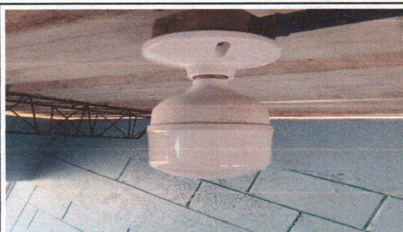
Foto 2: energia electrica. (cable, plafoneras y focos)
