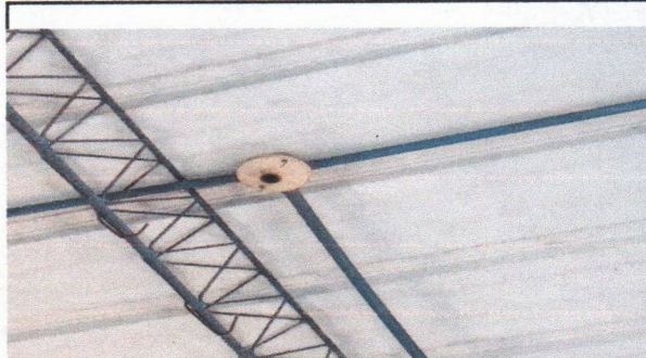
Foto 2: energia electrica. (cable, plafoneras y focos)
