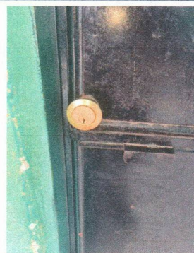
Foto 6: Sustrucción de chapa.
