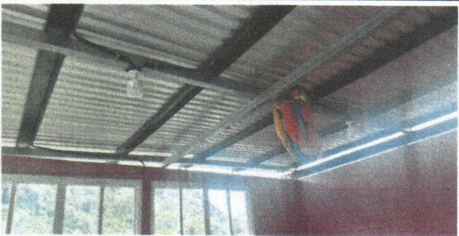
Foto 5: Instalación eléctrica de aulas
