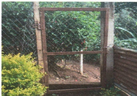
Foto 1: Sustitución de portón de metal. Portón de ingreso en mal estado
