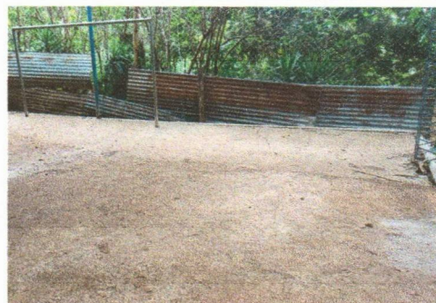
Foto 4: Piso de concreto deteriorado por lo que es necesario sustituirlo nuevamente
