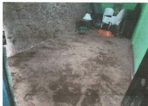
Foto 2: Piso deteriorado por lo que es necesario sustituirlo por piso de granito
