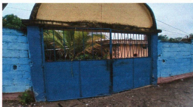
Foto 4: EL PORTÓN DE LA ENTRADA PRINCIPAL A LA ESCUELA YA ESTA MUY OXIDADO Y ROTO, ES CONVENIENTE CAMBIARLO.
