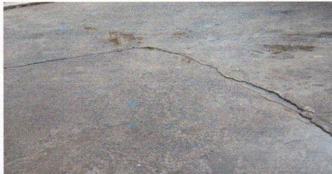
Foto 2: EL PATIO DE LA ESCUELA YA ESTA MUY AGRIETADO Y LOS NIÑOS SE TROPIEZAN A LA HORA DE HACER EDUCACIÓN FÍSICA.
