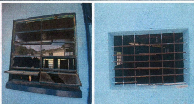
Foto 3: LAS VENTANAS DE LAS AULAS DEL MODULO 2 DE LA ESCUELA, YA ESTA EN MUY MALAS CONDISIONES.
