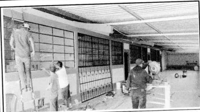
Foto 3: Sustitución de balcones que que el centro educativo no es seguro.
