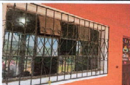
Foto 5: Se le dará mantenimiento a los balcones de metal, ya que se encuentran en mal estado.
