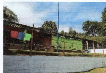
Foto 6: Se realizará sustitución de baranda de metal, ya que la actual se encuentra en mal estado poniendo en riesgo la integridad física de los alumnos.
