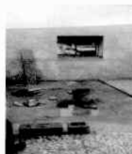
Foto 4: Repello y cernido en muros
