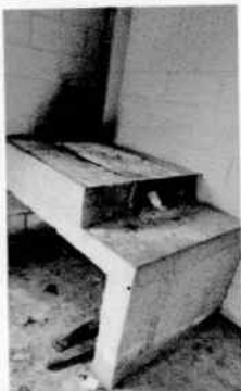
Foto 1: Plancha de cocina en mal estado debe cambiarse.
