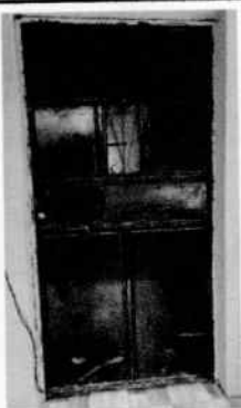
Foto 3: puerta con aboyaduras en el marco y en algunas partes, debe ser reemplazada.
