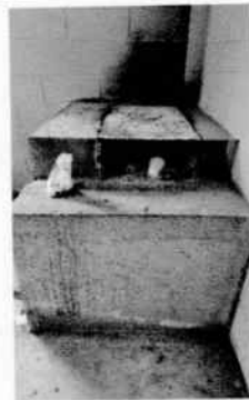
Foto 2: Mesa de concreto en mal estado donde debe colocarse una plancha nueva. Debe de ser reconstruida.
