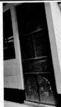
Foto 4: Puerta deteriorada en mal estado, debe ser reemplazada.
