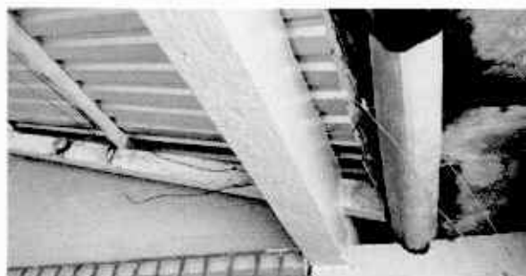
Foto 6: Sustrucción de cableado eléctrico
