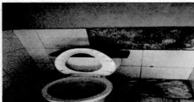
Foto 1: Renglón 4. Servicio Sanitario y sus accesorios
