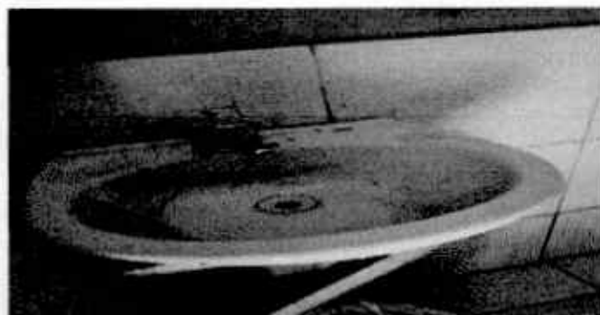
Foto 2: Renglón 4. Servicio Sanitario y sus accesorios
