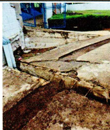
Foto 8: Se realizará reparación de rejilla metálica, para evitar accidentes.
