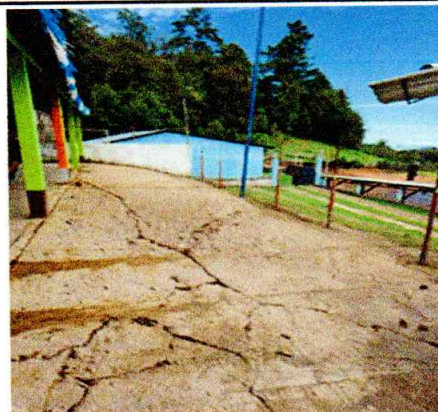
Foto 4: Se realizará reparación de plancha de concreto de patio, ya que la actual se encuentra en muy mal estado.
