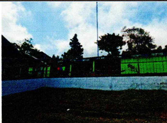
Foto 7: Se realizará sustitución de baranda de metal, para protección de los estudiantes y seguridad del centro educativo.
