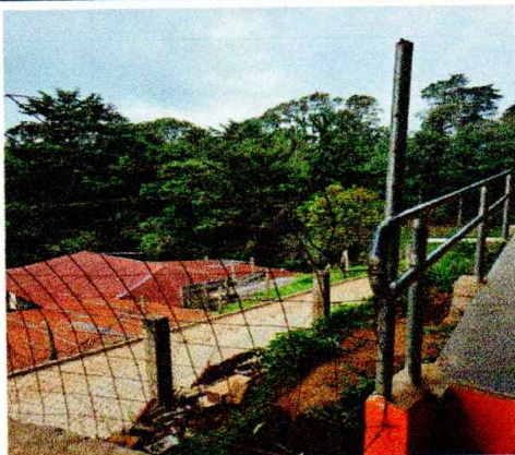
Foto 1: Se realizará reparación de cerco perimetral, para mayor seguridad de los niños, ya que se han tenido registro de accidentes y heridos.
