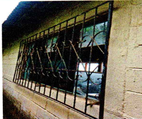
Foto 2: Se realizará mantenimiento a balcones, a estructura de metal de ventanas y cambio de vidrios y así contar con mayor seguridad en las aulas del centro educativo.
