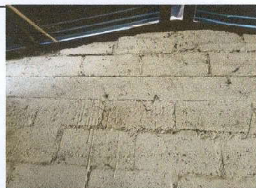
FOTO 11 Repello en muro de Cocina
