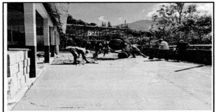
Foto 6: Torta de cemento
