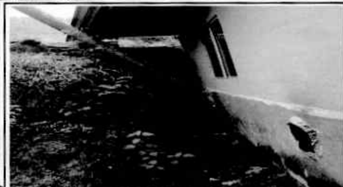
Foto 1: A la cocina le hace falta chimenea y está una pero en mal estado
