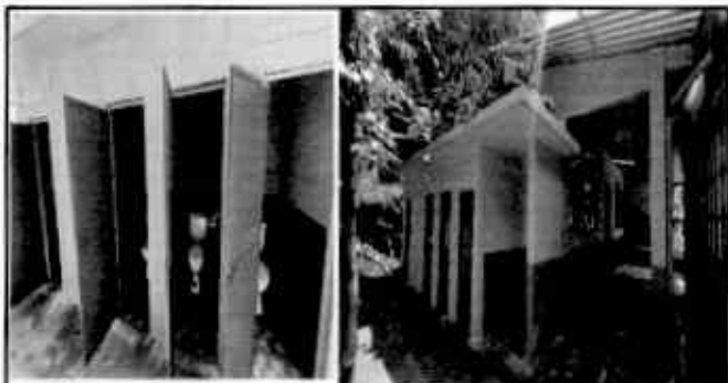
Foto 5: es necesario dar mantenimiento a las puertas que se encuentran en mal estado y cambiar los inodoros actuales estan en mal estado.
