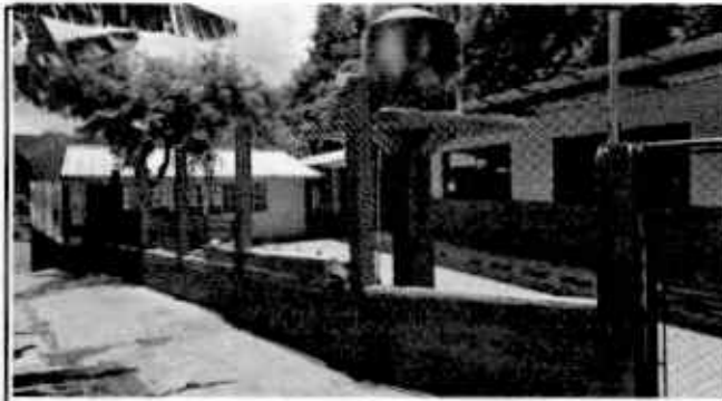
Foto 4: mal estado de la malla perimetral.
