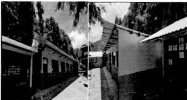
Foto 6: La pintura de la mayoría de las áreas de toda la escuela esta muy deteriorada. Se necesita pintar toda la escolita.
