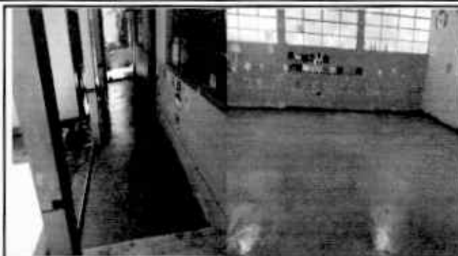
Foto 2: mal estado de torta de cemento.
