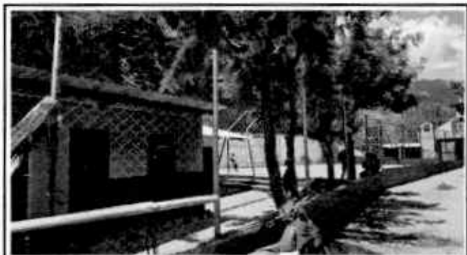
Foto 3: mal estado de la malla perimetral.
