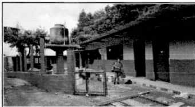
Foto 4: mal estado de la malla perimetral.
