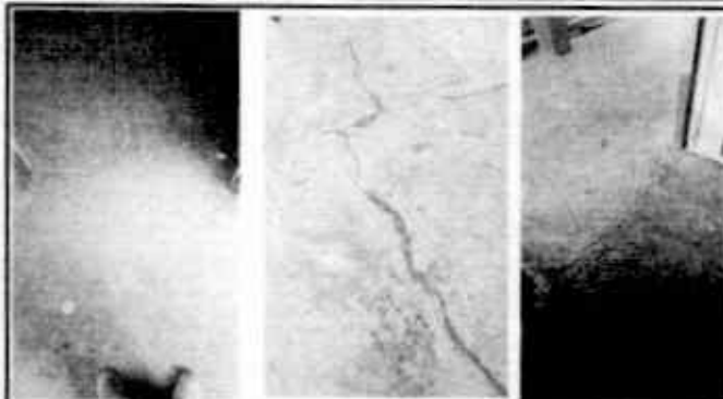
Foto 2: mal estado de torta de cemento
