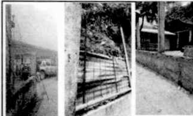
Foto 4: mal estado de la malla perimetral.
