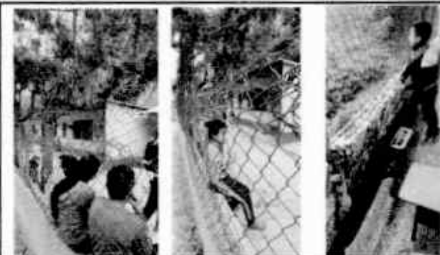
Foto 3: mal estado de la malla perimetral.
