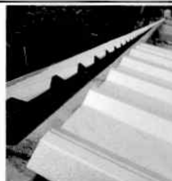
Foto 5: Renglón 1. 1.2 Sustitucion de capote de lamina para lamina troquelada
