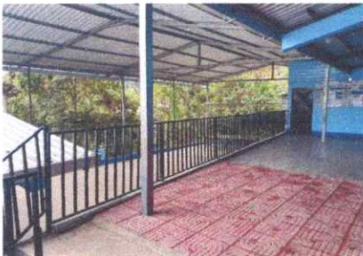
Foto 5: Sustruir malla dañada por baranda metálica
