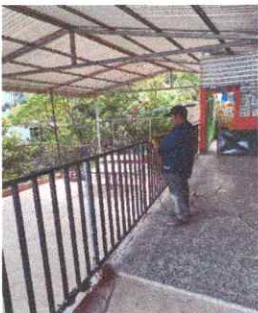
Foto 5: Sustituir malla dañada por baranda metálica
