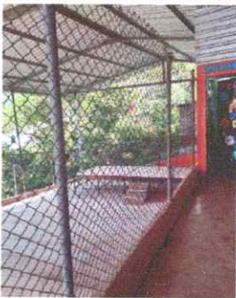
Foto 5: Sustruir malla dañada por baranda metálica
