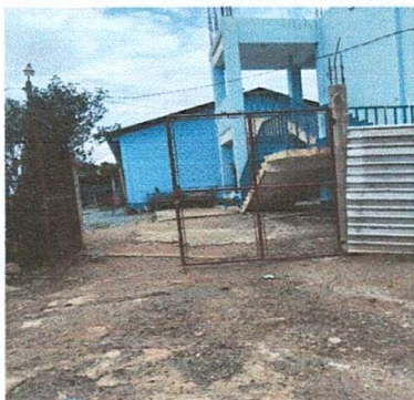
Foto7: porton de malla en mal estado
