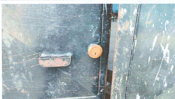
Foto 4: Porton dañado y chapa falsa
