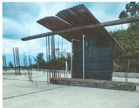
Foto 2: Soporte dañado y rotoplas en mal estado
