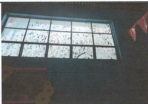
Foto 5: vidrios de ventanas quebrados y manchados
