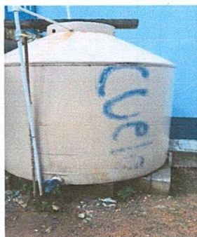
Foto 11: Rotoplas con fuga de agua
