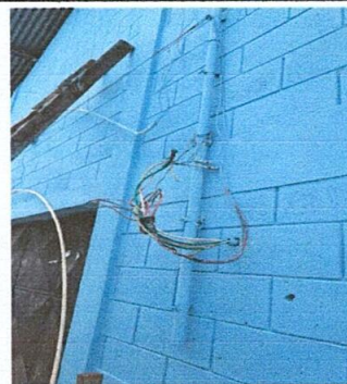
Foto 12: cables de luz en mal estado
