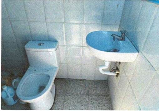
Foto 7: servicios sanitarios y sus accesorios
