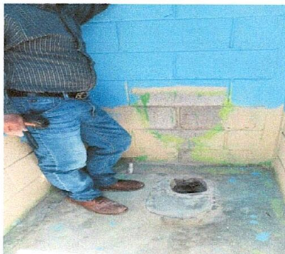
Foto 7: servicios sanitarios y sus accesorios
