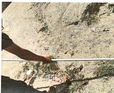
Foto 9: red de agua potable.
