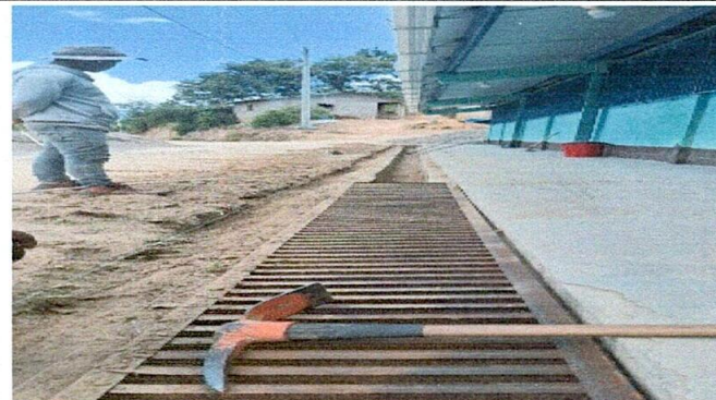
Foto 2: Es necesaria la reparación de las cunetas de concreto y mejoramiento con rejillas para evitar accidentes y para que corra el agua.
