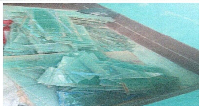
Foto 6: a las ventanas desde hace 20 años no se les ha dado mantenimiento, por lo que fue necesario el cambio de vidrios.
