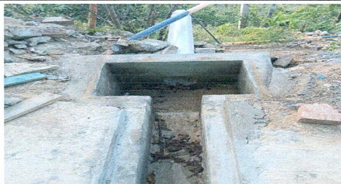
Foto 4: Es importante la reparación de la red de drenaje para prevenir y para que salga con mas facilidad las aguas pluviales.
