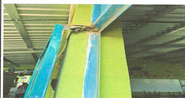
Foto 10: puertas en mal estado
