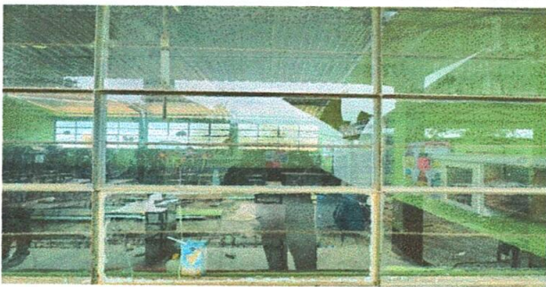
Foto 9: vidrios quebrados, ingreso de agua y polvo a las aulas
