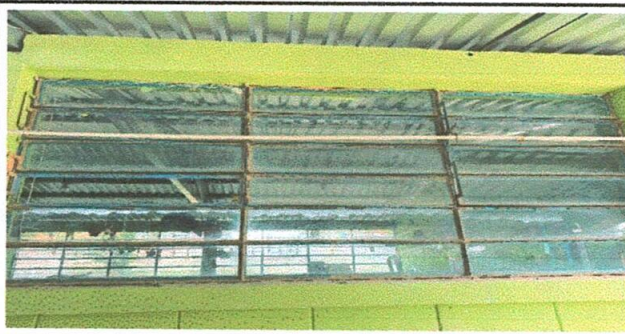
Foto 16: mejoramiento de pegamento que sostiene los vidrios
