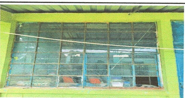
Foto 18: ventanas oxidadas y deterioradas
