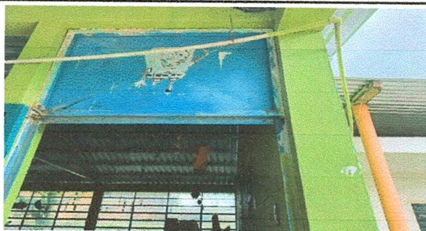
Foto 11: deterioro de puertas
