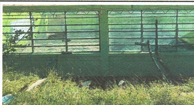
Foto 14: Deterioro de ventanas
